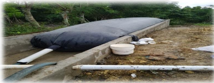
Digestor digester de UNIBE/ MESCYT durante instalación en Gonzalo, Monte Plata
