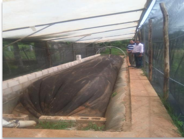
Digestor de caucho EPDM de 42 m3 instalado en la granja del Sr. Santana
