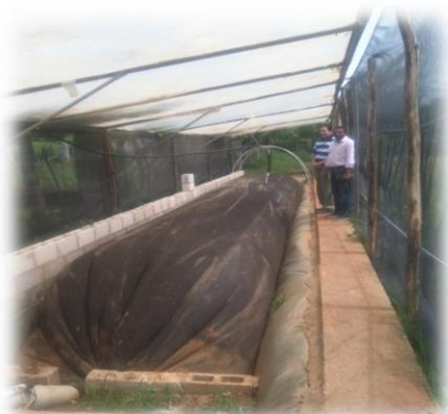
Primer digestor instalado en la granja del Sr. Electo Santana en Guanuma
